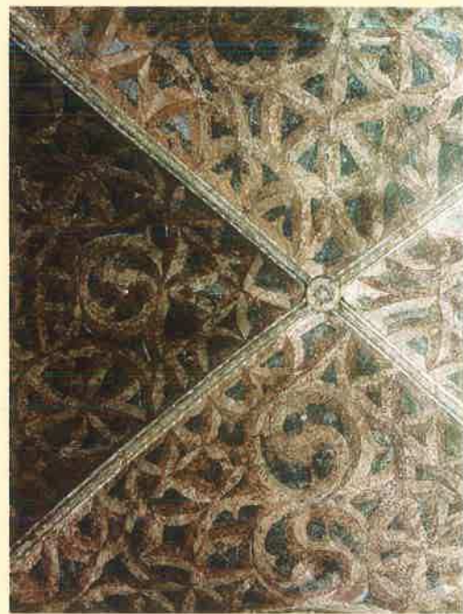
Maßwerkmalerei im mittleren Gewölbe. Malerei um 1500. Zustand vor Beginn der Restaurierungsmaßnahme 2000. (Foto: W. Sitte)
