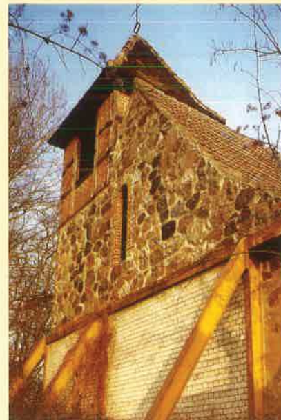
Kirche Möglin, notgesicherte Westwand
