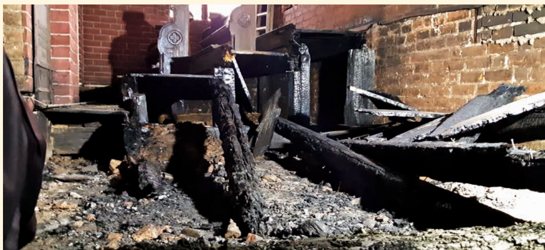
Brandschaden auf der Südempore des Chores
