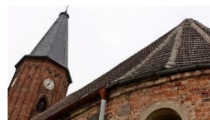
Baufälliger Turm Wachow (HVL) Foto: Astrid Wiebe
