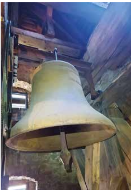
Große Glocke vor dem Rostschutzanstrich
