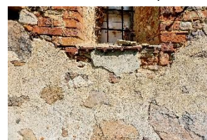
Dorfkirche Tackern, Schaden an der Fensterbank, Foto: Deutsche Stiftung Denkmalschutz
